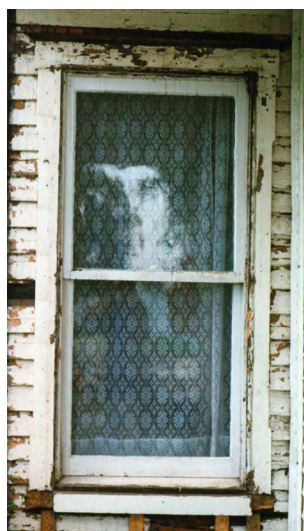
4. Condition du chambranle et de l'appui de fenêtre (vinyle en moins).
