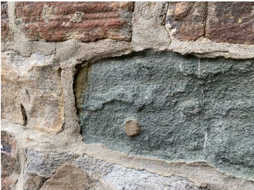
Mortier de ciment Portland qui induit des dégradations (désagrégation) à la pierre à proximité plutôt que de jouer son rôle sacrificiel.
