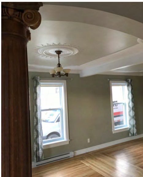
Vue du plafond du salon avec les moulures et la rosette en plâtre après la restauration.
