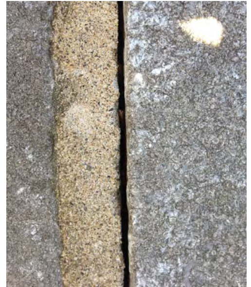
Dégradation typique d'un joint de mortier de ciment Portland qui, dû à sa rigidité et sa densité, s'est décollé d'un côté et est extrêmement adhérent de l'autre.
