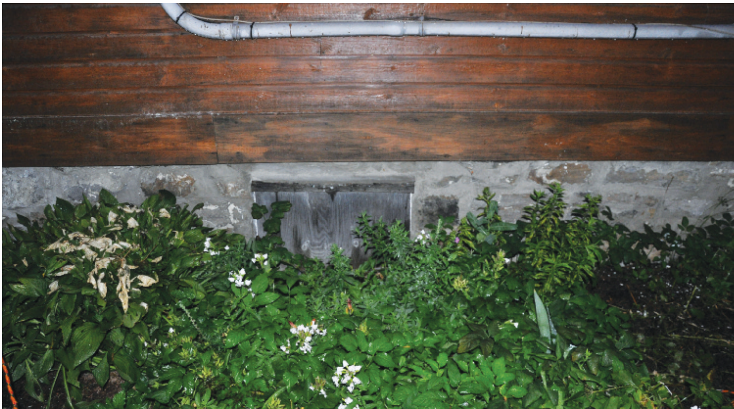
Soupirail obstrué, à reconduire si aucune ventilation mécanique présente.
