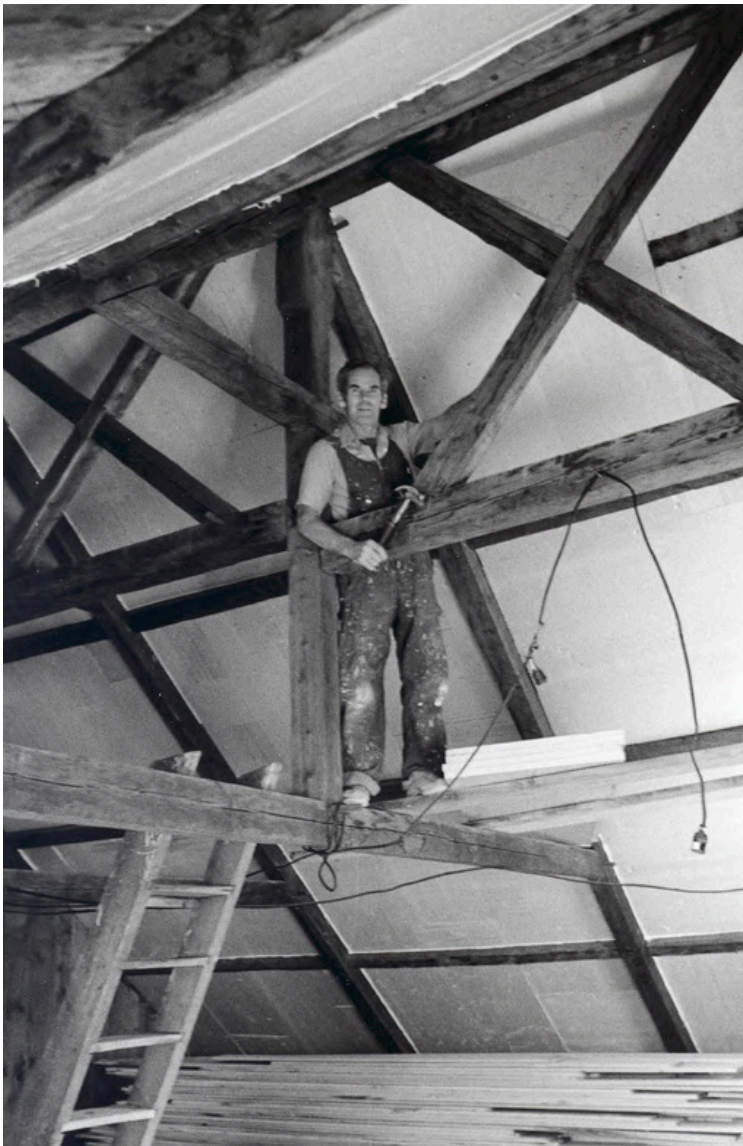
Vue des travaux de restauration des combles par Robert Lamontagne, célèbre artisan de la région de Bellechasse
