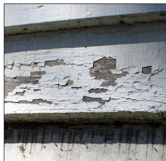
Parement de planche à clin montrant une grande détérioration de la peinture, qui doit être complètement enlevée.
