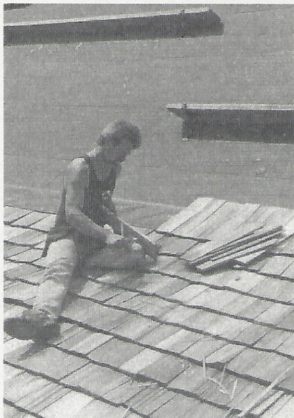
Photographie illustrant une partie de la technique de pose du nouveau bardeau. Les larges planches de pin sont recouvertes, au départ, d'un contreplaqué suivi d'un papier à couverture goudronné autocollant et ensuite, d'une membrane plastifiée alternant entre les rangées de bardeaux fendus à la main.
