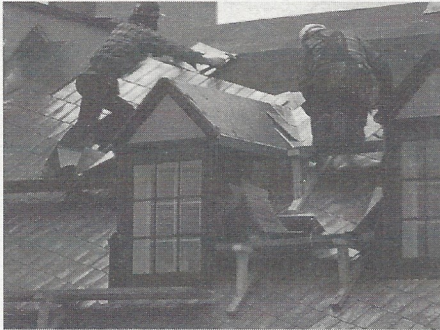
Artisans-tôliers occupés à refaire une toiture traditionnelle en tôle «à la canadienne» Photo : «Couvertures traditionnelles» (Héritage-Montréal, 1984)
